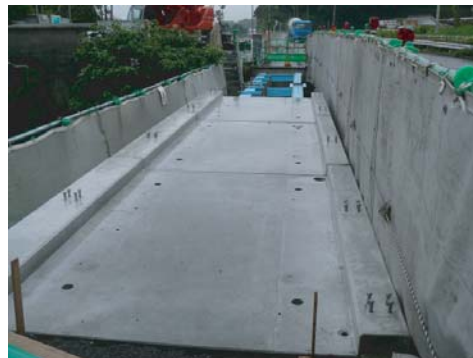
既設桁等の補修を実施後、ダクトスラブ6枚敷設(参考質量:2731kg/枚)
