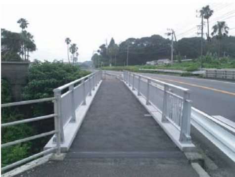
転落防止柵用のアンカーボルトを埋め込んで製造ダクトスラブ上にアファルト舗装実施
